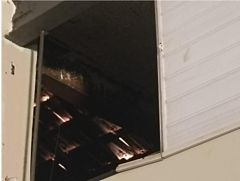
Figura 5. Destaque para o mau estado de conservação da cobertura.
