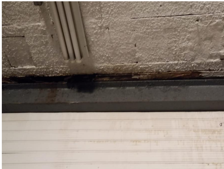
Figura 8. Sinais de corrosão na estrutura metálica do imóvel.
