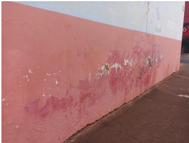
Figura 2. Sinais evidentes de infiltração na parte externa do imóvel.
