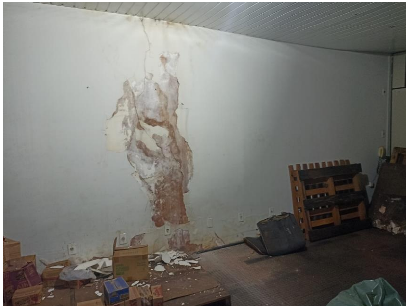
Figura 6. Estado deteriorado da alvenaria, forro e estrutura do imóvel, sublinhando a urgência de reparos e manutenção.
