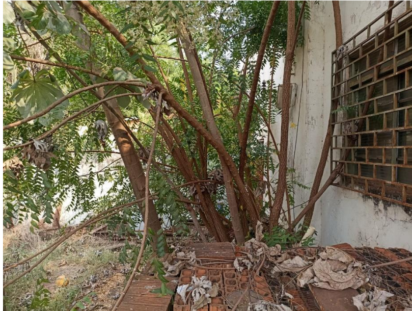
Figura 3. Esquadrias em estado precário e infiltrações evidentes nas alvenarias, destacando os problemas estruturais do imóvel.
