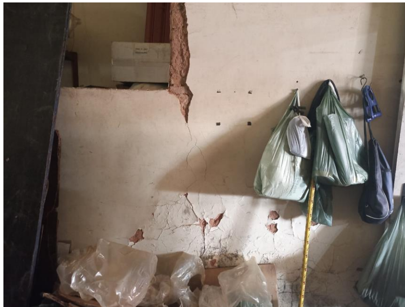
Figura 4. Condições precárias da alvenaria e da estrutura do imóvel, indicando problemas sérios de conservação.
